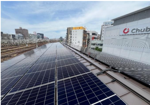
太陽光パネル
