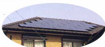
住まいのエネルギー源として家計を支える、3.5kwのソーラー発電パネル。
