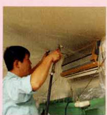
エアコン内部
