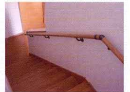
階段に手すりを
